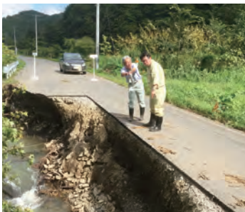
台風10号災害現地調査
